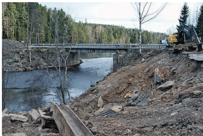
Det skal bli ny bru på Otteid. Kun ett kjørefelt har vært åpent på Grislingås Bru i senere tid.
